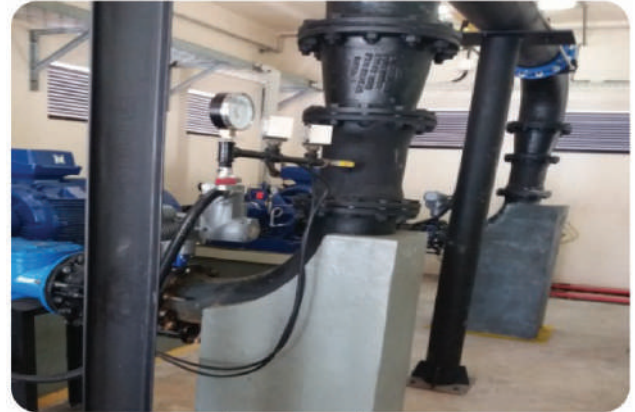
කෙරමිනිය හුවන පොම්පාගාරය තුළ සම්පූර්ණයෙන් නිම කරන ලද හුවන පොම්ප ස්ථාපනය කිරීම
